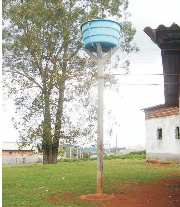
Fig. 6. caixa da água exposta ao sol.
